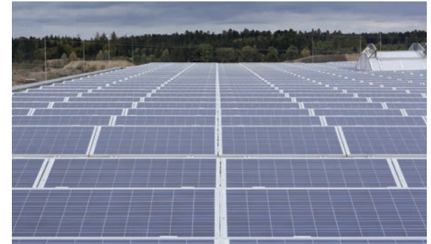
zonnepanelen op een bedrijfspand
